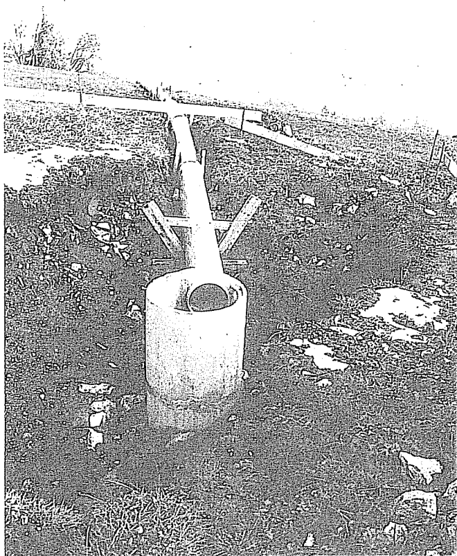
Notleitung als Ersatz für die verstopfte Bacheindohlung beim "Vorderberg" des EWB.
